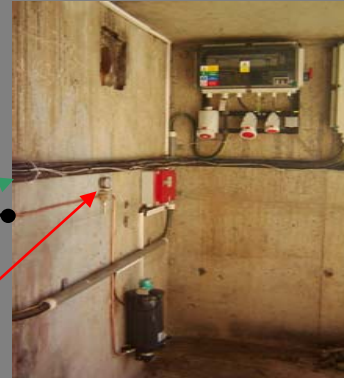
POHLED NA UMÍSTĚNÍ MAZACÍHO PŘÍSTROJE A KONTROLNÍ KOSTKY
